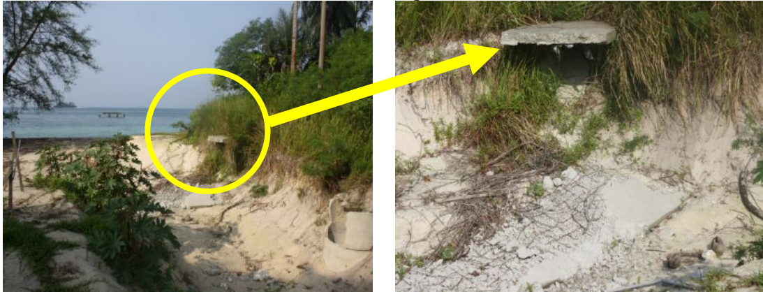
Gambar 2.14 Slab/Jalan Simen Yang Telah Runtuh
