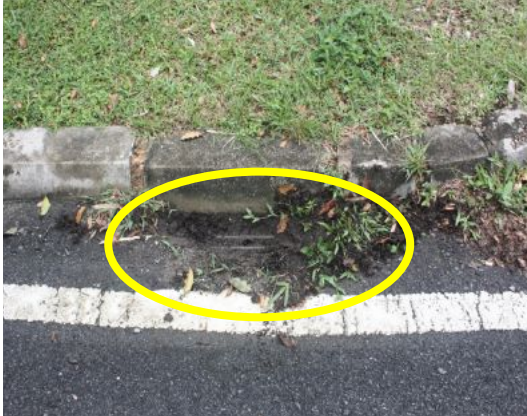
Gambar 1.41 Scupper Drain Dipenuhi Pasir Dan Rumput
