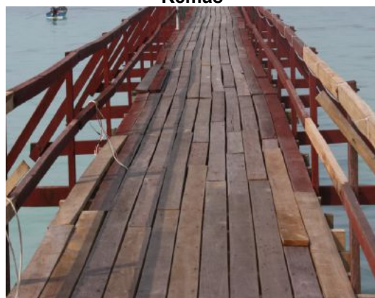
Gambar 2.24 Pemasangan Lantai Jeti Yang Tidak Kemas
