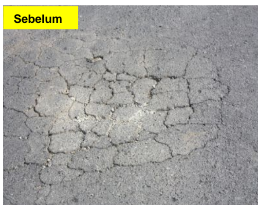
Gambar 1.10 Kerosakan Jalan Jenis Retak Buaya
