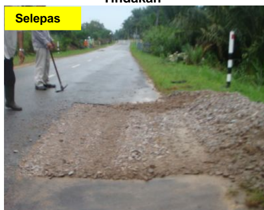
Gambar 1.11 Kerosakan Jalan Sedang Diambil Tindakan
