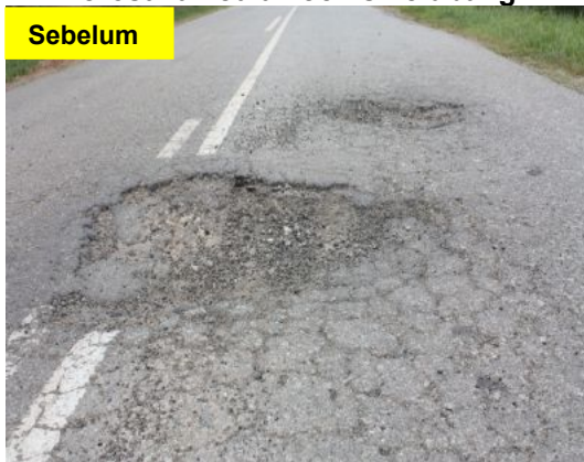
Gambar 1.18 Kerosakan Jalan Jenis Lelubang
