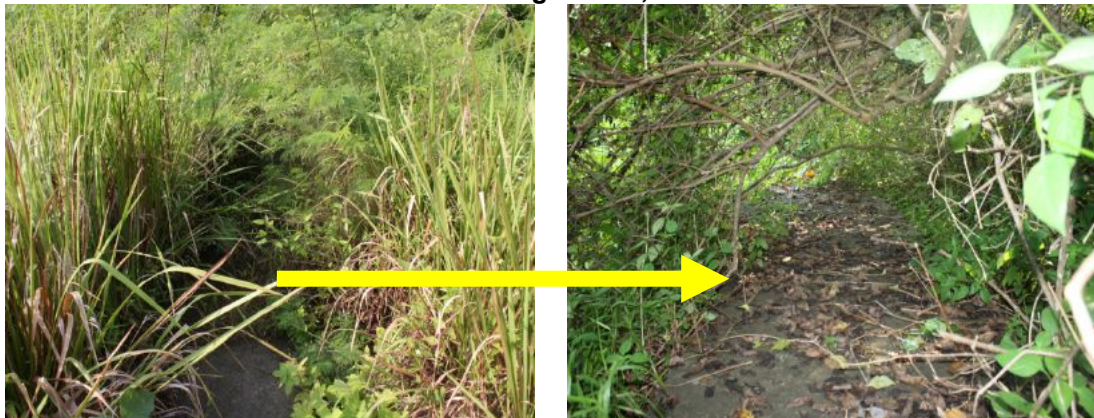
Gambar 2.13 Slab/Jalan Simen Tidak Digunakan, Semak Dan Terbiar
