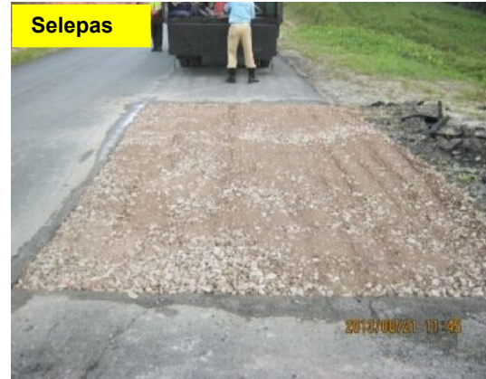
Gambar 1.13 Kerosakan Jalan Telah Diambil Tindakan
