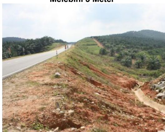
Gambar 1.6 Tiada Guardrail Di Kawasan Cerun Melebihi 3 Meter
