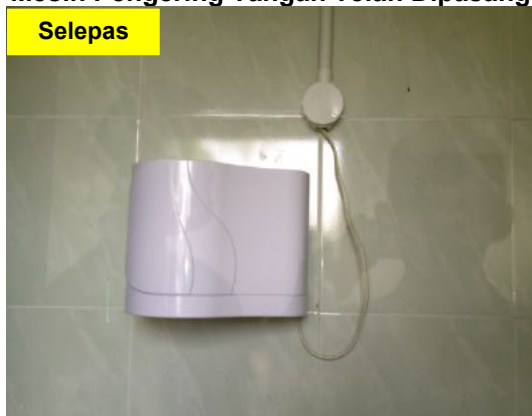
Gambar 3.19 Mesin Pengering Tangan Telah Dipasang
