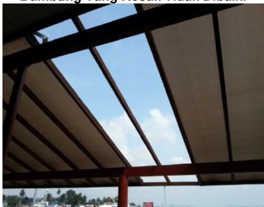
Gambar 4.11 Bumbung Yang Rosak Tidak Dibaiki
