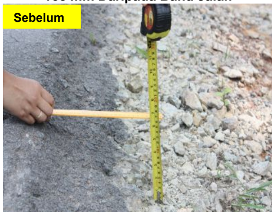
Gambar 1.21 Permukaan Jalan Berbeza Sebanyak 165 mm Daripada Bahu Jalan
