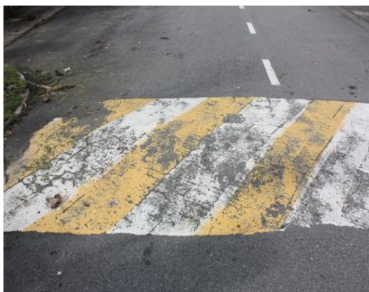
Gambar 1.24 Cat Pada Bonggol Jalan Telah Pudar
