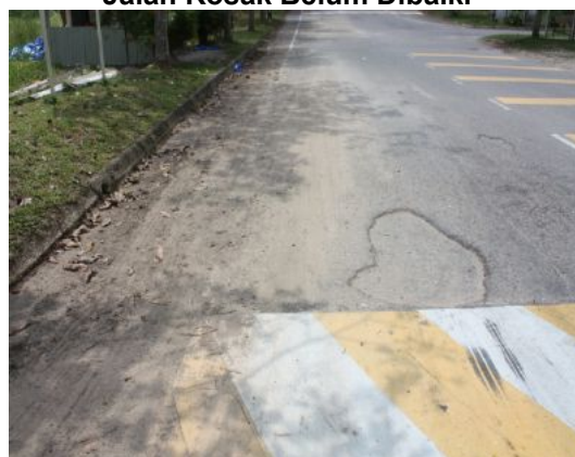
Gambar 1.29 Jalan Rosak Belum Dibaiki
