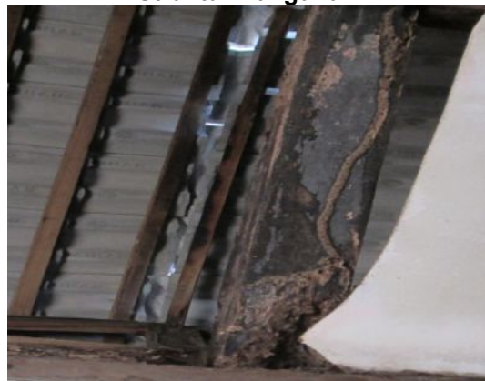
Gambar 4.24 Serangan Anai-Anai Yang Merosakkan Struktur Bangunan
