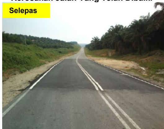
Gambar 1.2 Kerosakan Jalan Yang Telah Dibaiki
