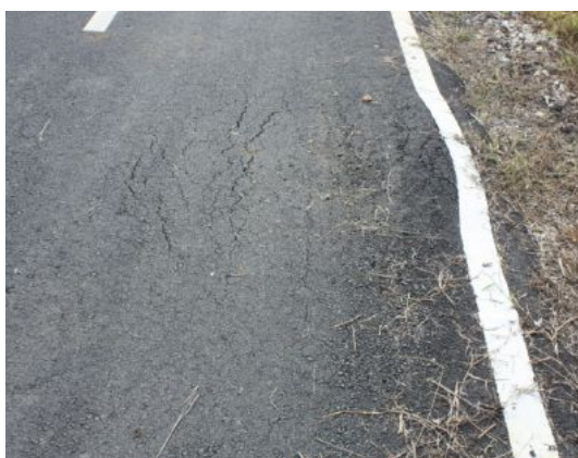
Gambar 1.16 Kerosakan Jalan Jenis Shoving
