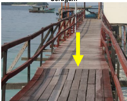
Gambar 2.23 Pemasangan Lantai Jeti Yang Tidak Seragam
