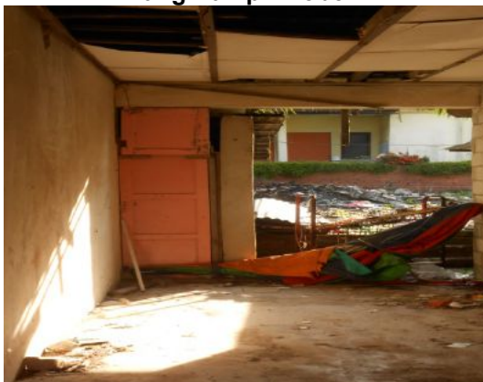
Gambar 4.23 Struktur Bangunan Yang Hampir Roboh
