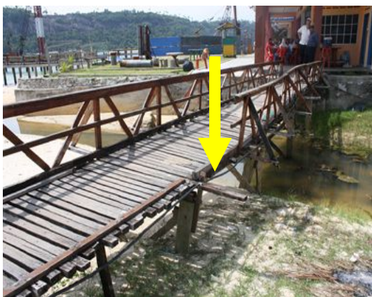
Gambar 2.19 Kayu Pemegang Jambatan Telah Patah
