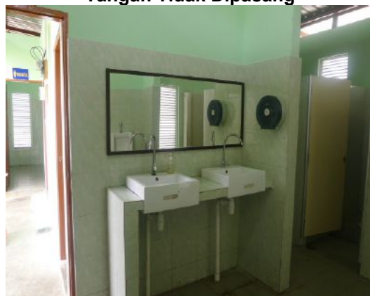
Gambar 3.18 Tempat Sabun Dan Mesin Pengering Tangan Tidak Dipasang
