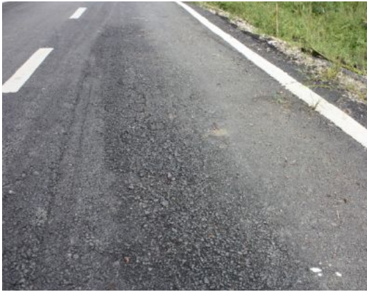
Gambar 1.17 Kerosakan Jalan Jenis Pengikisan
