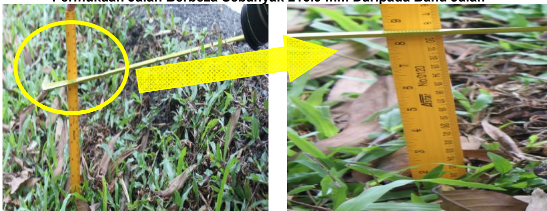
Gambar 1.23 Permukaan Jalan Berbeza Sebanyak 215.9 mm Daripada Bahu Jalan
