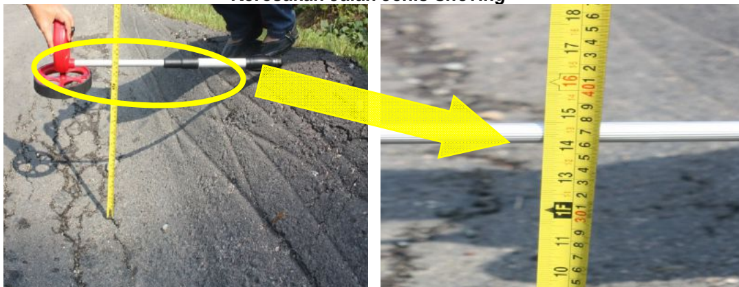
Gambar 1.15 Kerosakan Jalan Jenis Shoving
