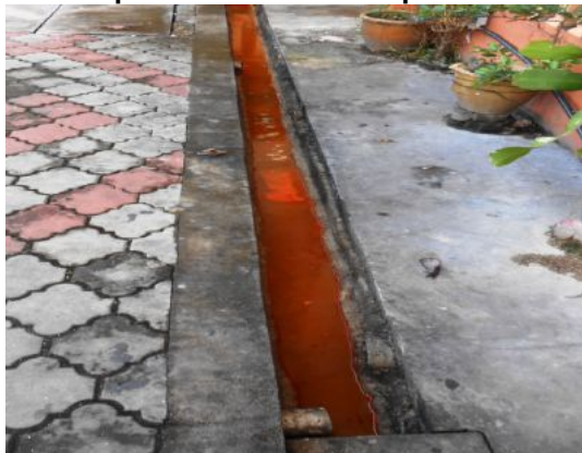
Gambar 4.16 Air Tidak Dapat Mengalir Dengan Sempurna Kerana Mendapan Pasir
