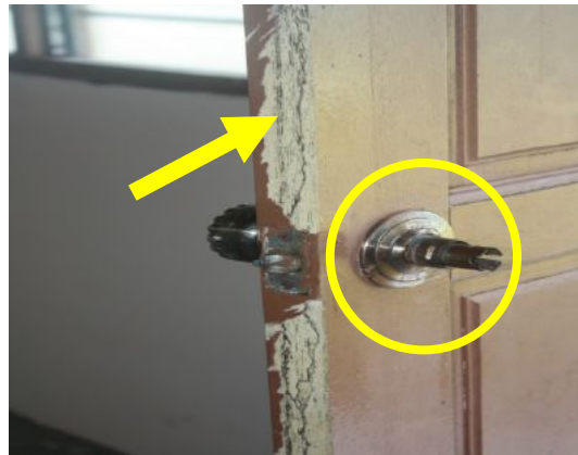
Gambar 2.10 Kerosakan Pada Tombol Pintu Masuk
