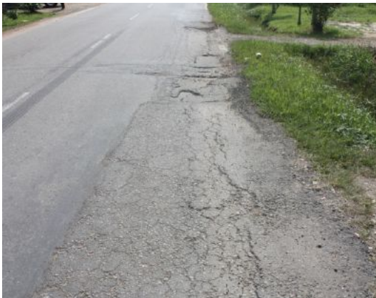
Gambar 1.14 Kerosakan Jalan Jenis Retak Tepi Jalan
