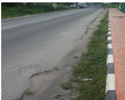
Gambar 1.20 Kerosakan Jalan Jenis Pecahan Tepi
