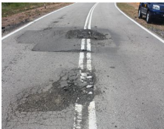
Gambar 1.7 Turapan Semula Jalan Telah Retak
